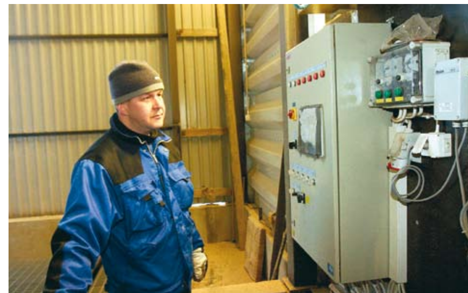
Janne Vähämöttönen: "Kuivurin ohjauskeskuksesta lähtee tekstiviesti jäähdytyksen käynnistyessä. Se jättää puolitoista tuntia aikaa toimia."
