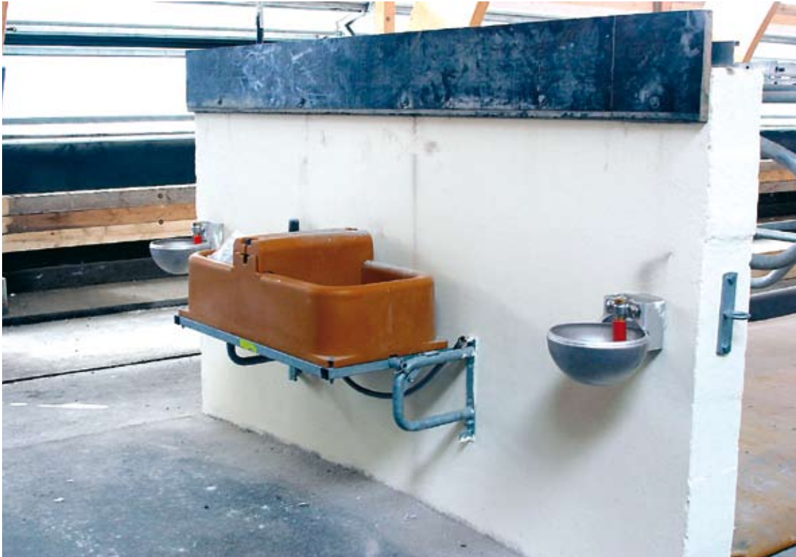
Palopostina toimiva vesipiste pikaliittimellä on helppo piilottaa matalan seinäkkeen yläosaan. Lehmän turpa ei mahdu päästä avoimeen koteloon. Tällaisia vesipisteitä on navetassa kuusi ja vielä tulee kaksi lisää. Ne helpottavat myös navetan pesutyötä. Letkukiepit sijoitetaan ulko-ovien pieliin.
