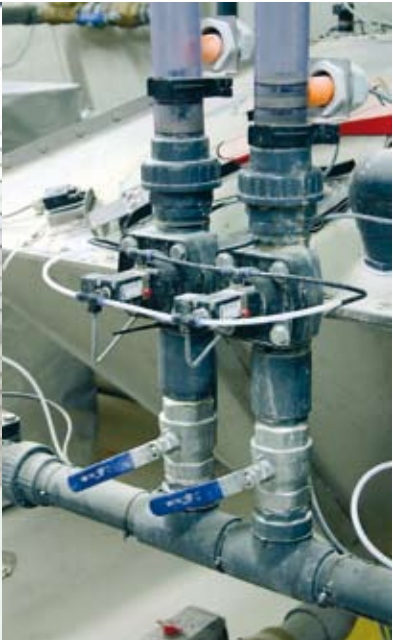
PipeJet-tulpat odottavat seuraavaa rehunjakoa putkilinjojen alkupäissä. Molemmissa linjoissa on lähtö puoliksi kuristettu, mikä osaltaan sekoittaa rehua. Pumpun kuluessa kuristusta voi avata.
