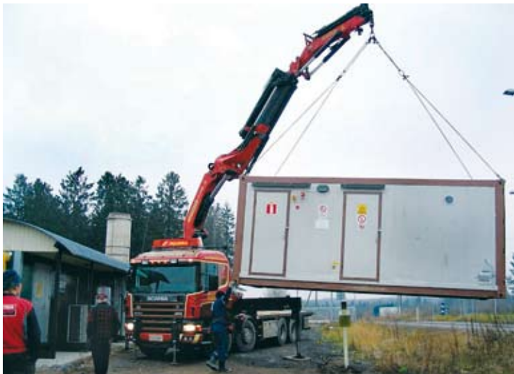
Metenerin kaasunpuhdistin tuodaan asennuspaikalle valmiina konttina. Laitteisto pystyy puhdistamaan noin 40 kuutiota raakakaasua tunnissa ja paineistamaan sen 200 bariin.
