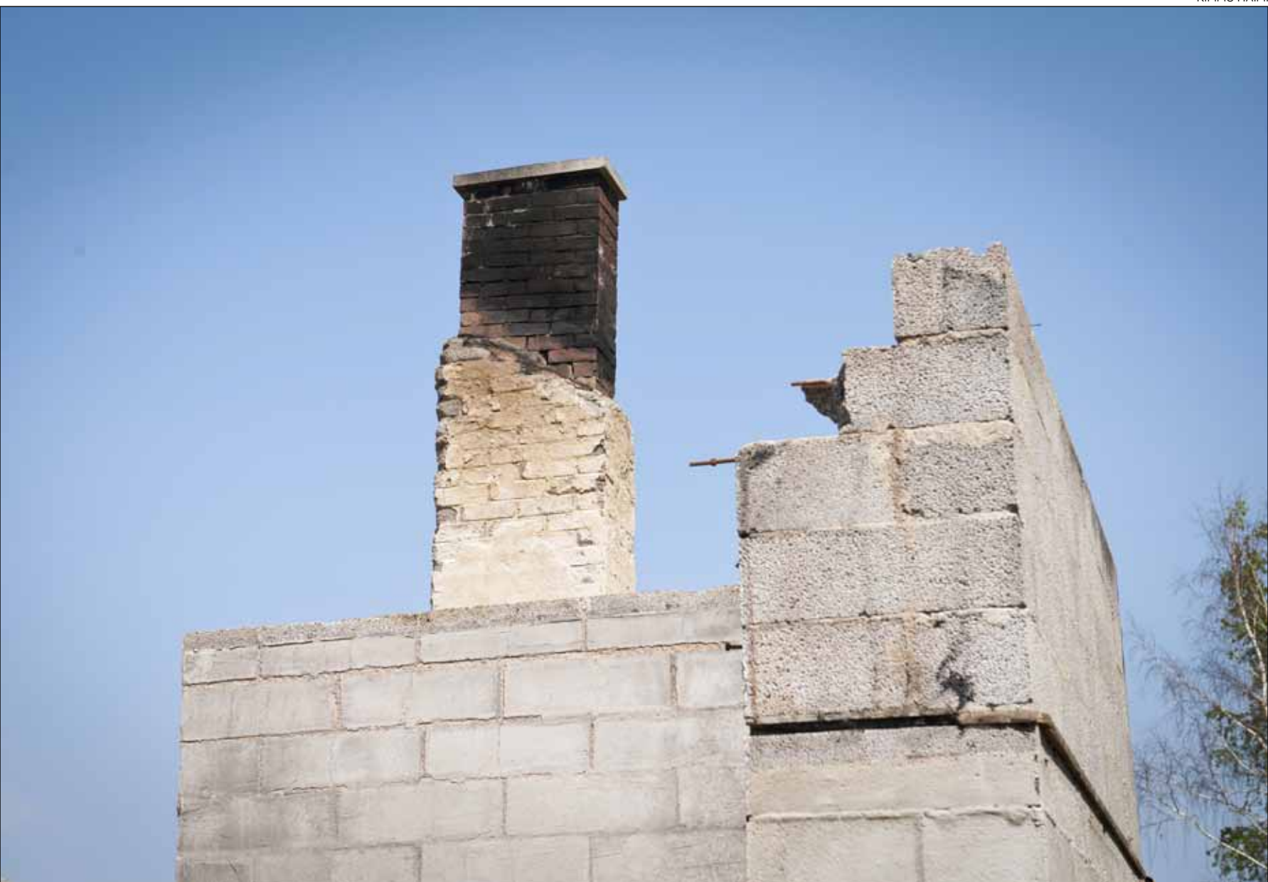
Vuonna 2010 riehui maatiloilla riehui ennätysmäärä tuhoisia tulipaloja. 38 tilalle koitui yli 200 000 euron vahingot.
