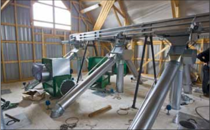
Tuoreviljasiiilojen tuuletuksesta vastaavat imurit ovat vielä sijoittamatta kuivurin yläkerassa.
