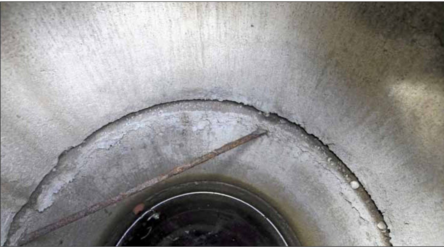
Tämän kaivon ylintä rengasta routa on liikuttanut. Saumasta pääsee pintavettä kaivoon. Rakenteiden ja saumausten täytyy olla täysin tiiviit.
