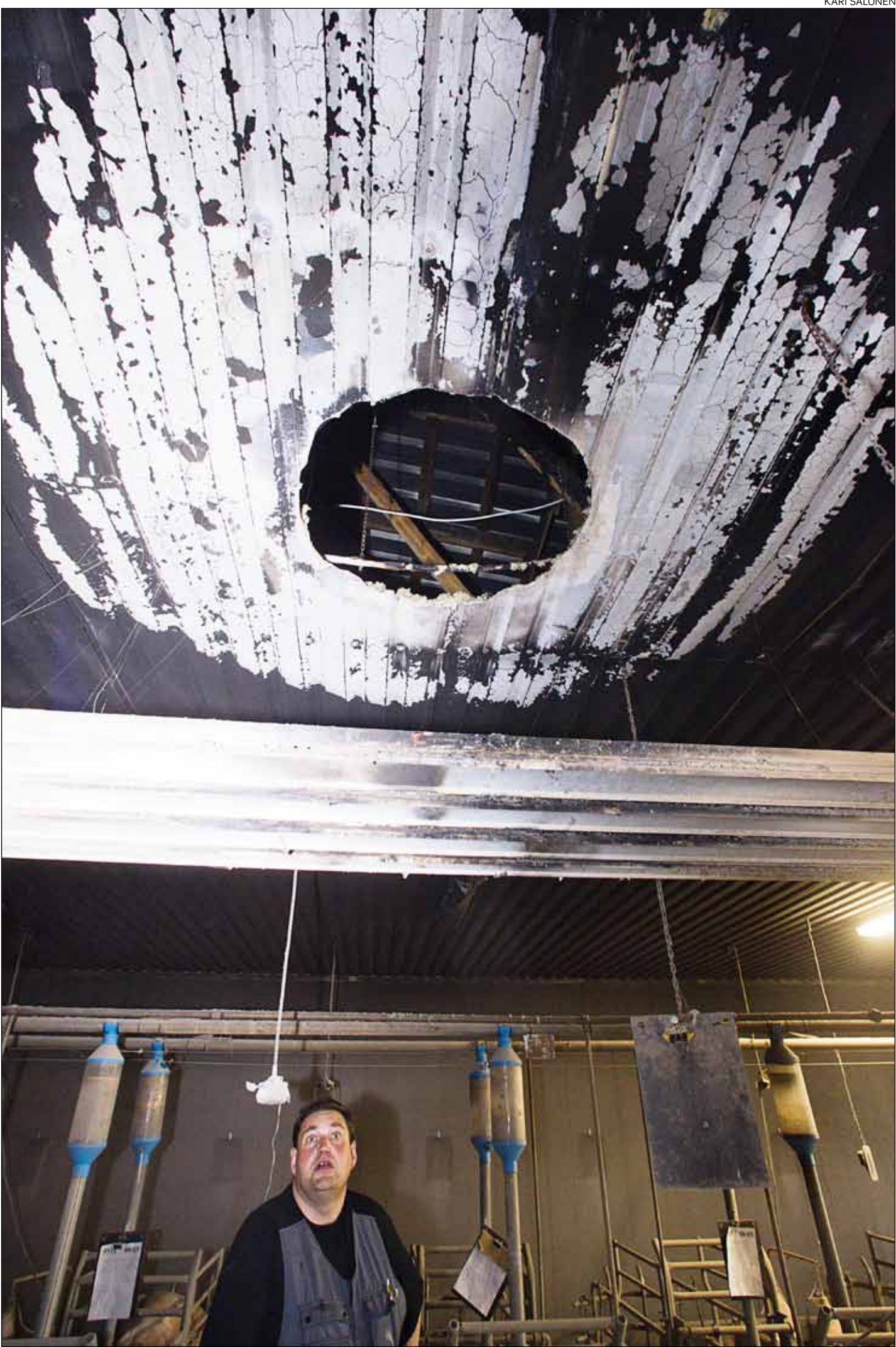
Martin Ylikännö tarkastelee paikkaa, mistä ilmastointilaitte sulii tulipalossa alas sikalan porsitusosastolle.
