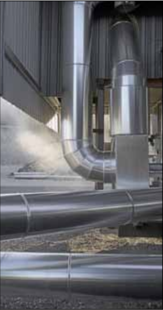
Uunin putkistosta purkautuva vesihöyry kertoo, että valmistuksessa on erä lämpöpuuta.
