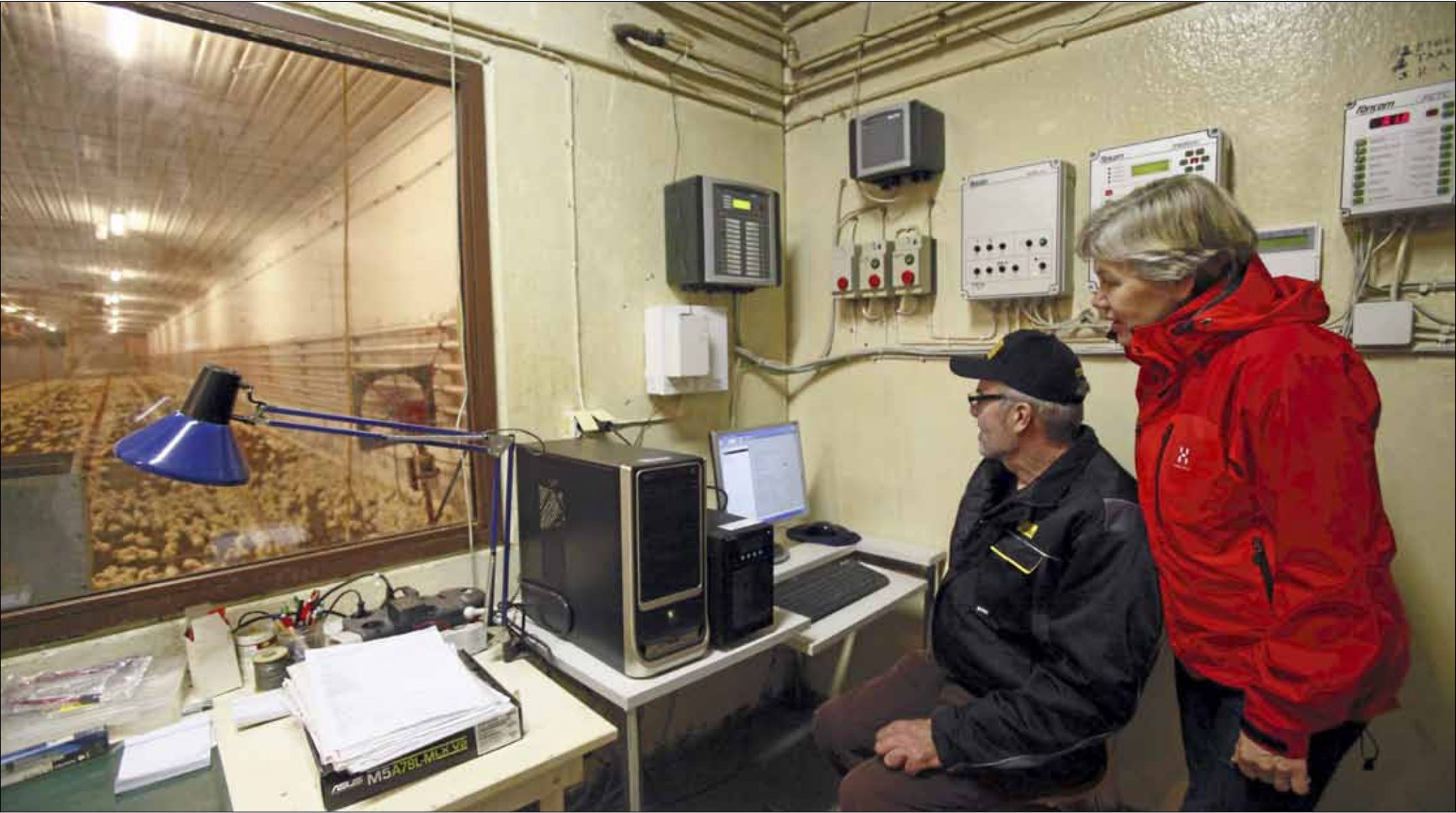
Sähkökatkoista aiheutunut riesa poistui ja stressi väheni, kun katkoille arat tietokoneet suojattiin upsilla, toteavat Tapio ja Irmeli Peltola Pöytyältä.
