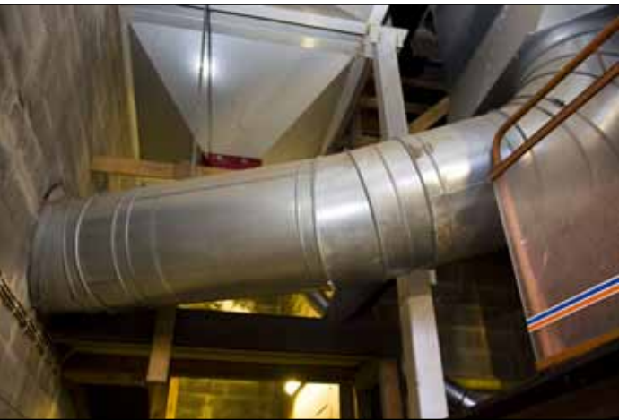
Kuivurin tuloilmapiutken eristäminen säästäisi energiaa.
