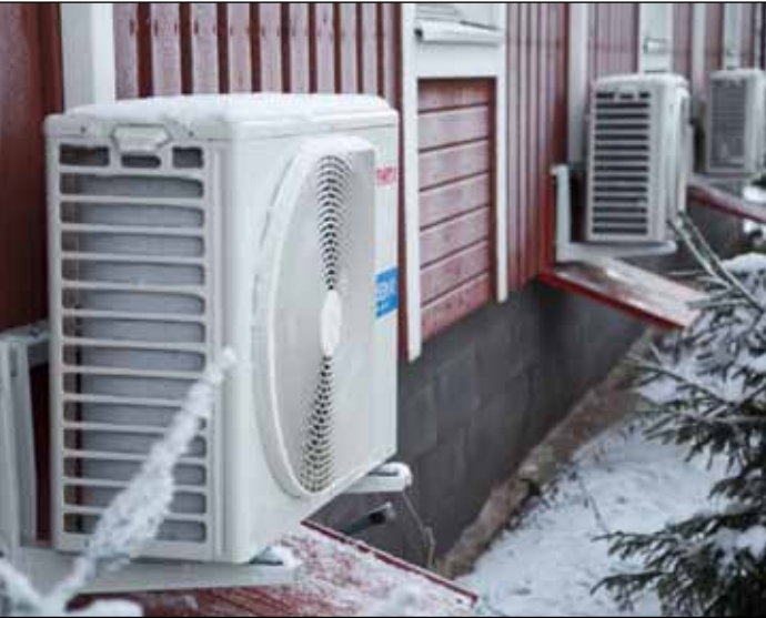
Kolme ilmalämpöpumppua pitävät konehallin lämpimänä. Samaan hintaan olisi saanut yhden suuren yksikön, mutta myyjän mukaan kolme pientä oli tehokkaampi ratkaisu.
