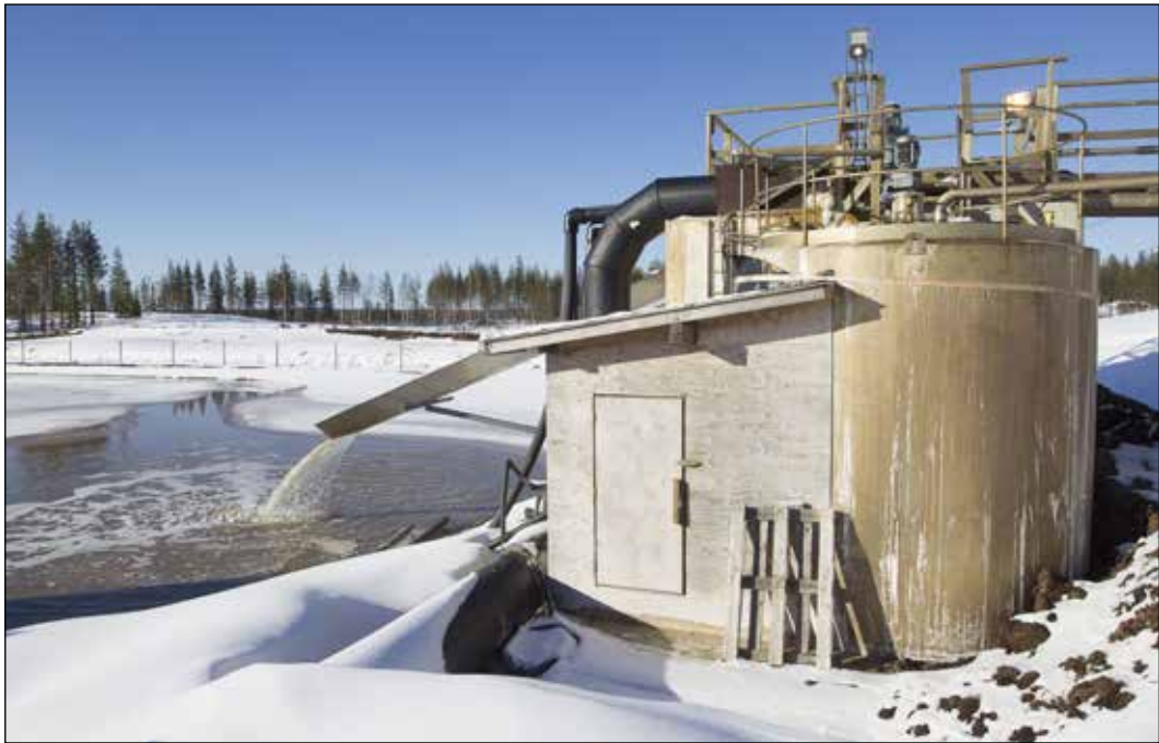
Luotuskasojen ympäriltä valuvat vedet johdetaan keräilylaitteisiin. Matkalla vesi vispataan säilyssä yhdessä kalkkimaidon kanssa. Vesi neutraloituu eli metallit saostuvat ja painuvat altaan pohjalle. Puhdistettu vesi johdetaan lopulta patoaltaisiin.
