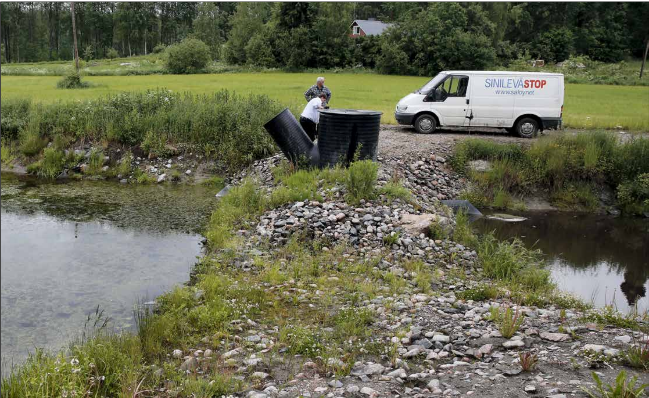
Fosforinpuhdistuslaitteen läpi virratessaan purovesi liuottaa mukaansa rautasulfaattia laitteen annostelijasta. Liukoinen fosfori ja veden kantama liukoinen humusaines sitoutuvat rautaan ja saostuvat kahden laskeutusaltaan pohjalle.
