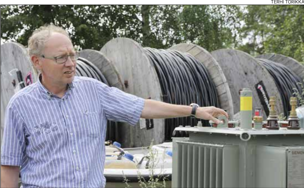
Taajamien sähköverkon kaapelointi etenee aikataulussa, mutta haja-asutusalueen uusien vaatimusten toteuttaminen tulee olemaan vaikeaa pienelle yhtiölle, kertoo Parikkalan Valon osastopäällikkö Olli Mattila. Taustalla näkyy maakaapeleita, edessä muuntaja.
